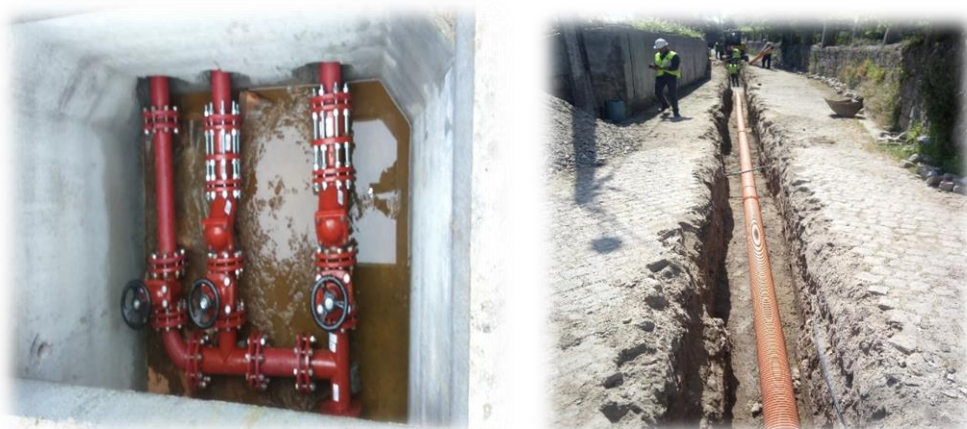
Figura n.º 7 e n.º 8 – Execução de estação elevatória e instalação do coletor de saneamento
