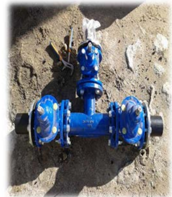
Nó de ligação da rede de água
