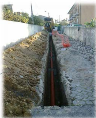
Rede residual na travessa das loursas, Santa Marta de Portuzelo
